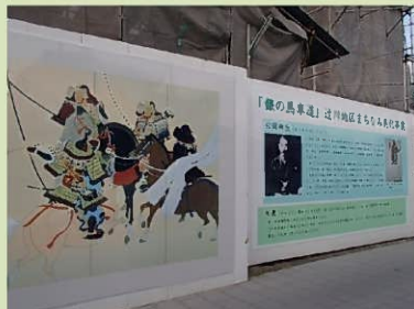
保存修理工事中の大庄屋三木家住宅の仮囲いには、柳田國男の弟・松岡映丘が描いた大和絵のラッピング看板が設置されています。
